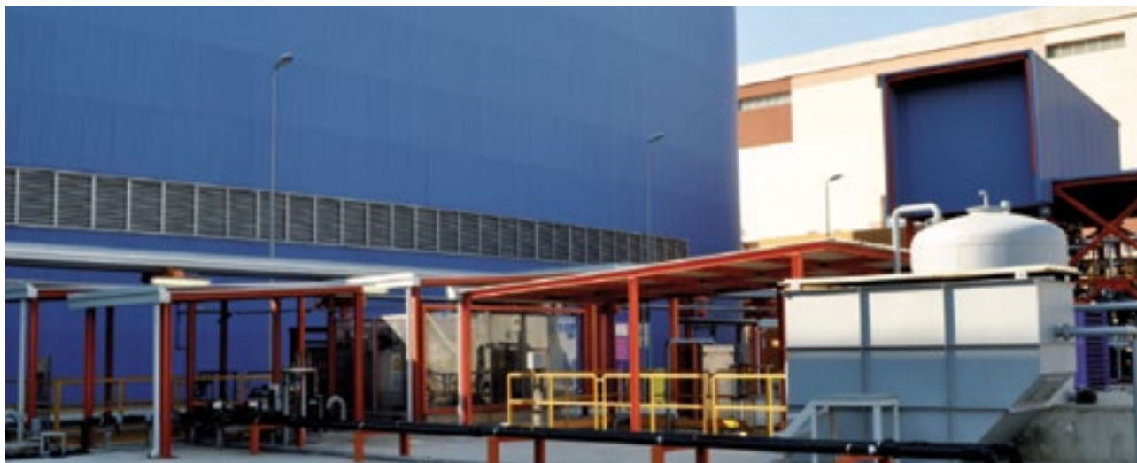
Figura 13: Impianto di Trattamento delle Acque Reflue
