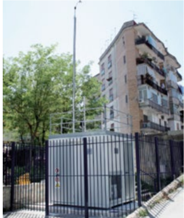
Figura n. 11: Centralina di Via Epomeo
