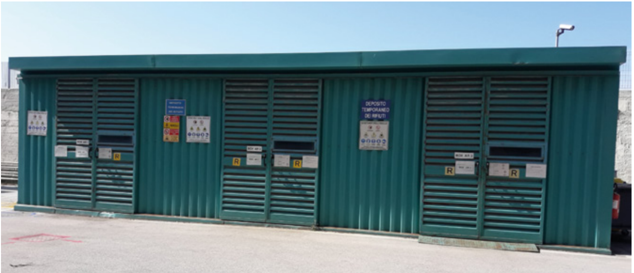
Figura 14: Deposito temporaneo rifiuti pericolosi
