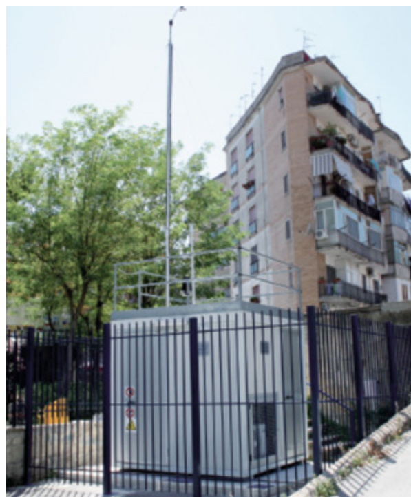
Figura n. 10: Centralina di Via Epomeo
